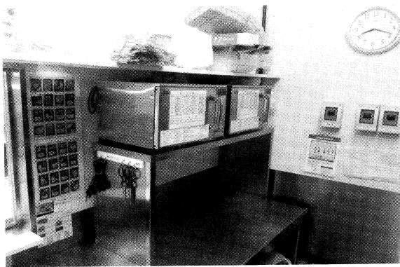
設置されたマルチ対応マイクロ波炊飯機
